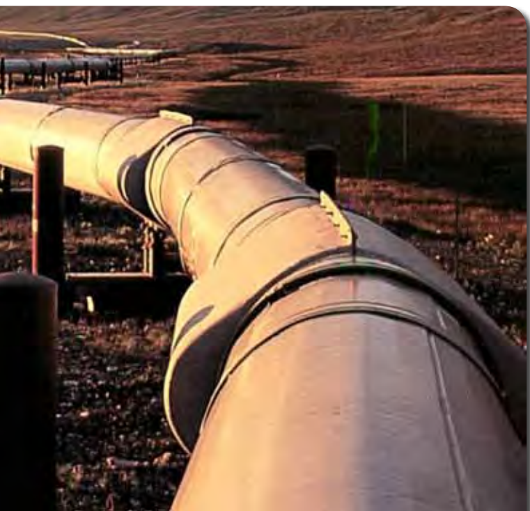
Ducto de Gas Natural
